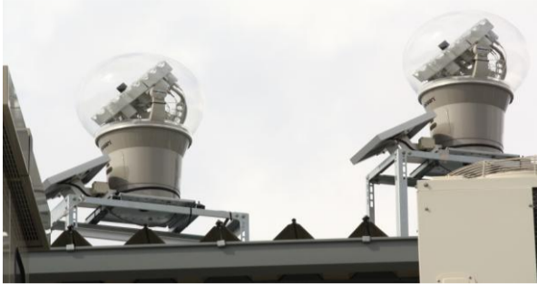
【屋上には太陽電池仕様12眼SB×2台】
