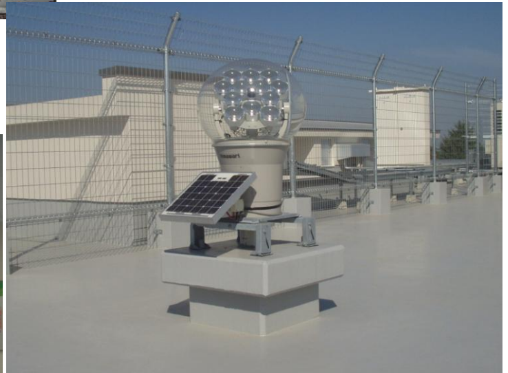
【3F建校舎屋上に設置された12眼ひまわり】
